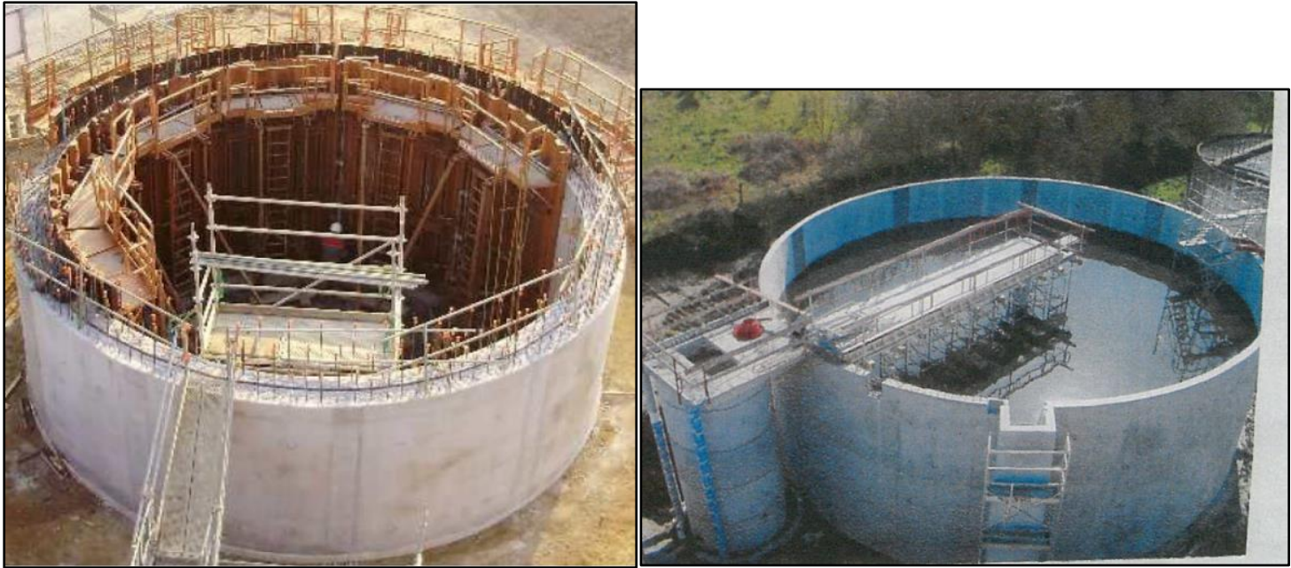
Bassins d'épuration biologiques en bassins béton circulaires
