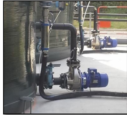
Pompe d'alimentation des éjecteurs
