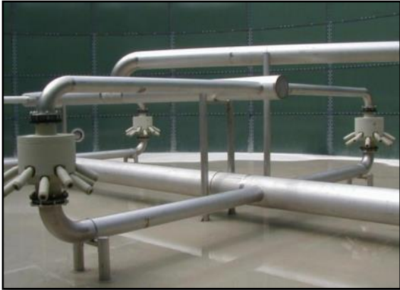
Ejecteurs d'aération en PP interne à la cuve
