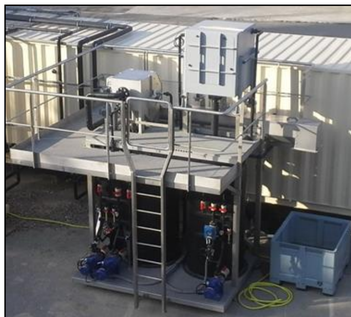
Poste prétraitement tamis rotatif + grille courbe installés sur plate-forme
