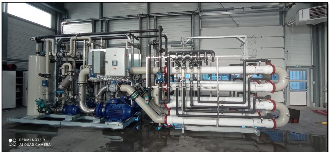
Boucle d'ultrafiltration montée sur skid et intégrée en bâtiment
